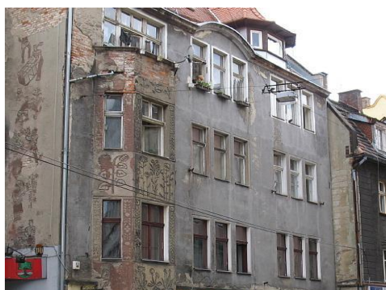
Budynek Wspólnoty Mieszkaniowej przy ul. Sienkiewicza 6 w Wałbrzychu (przed remontem elewacji i dachu).
